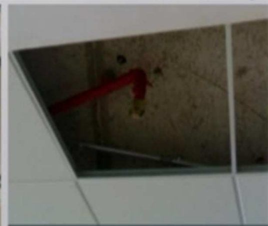
صوره توضح مخارج الحريق
