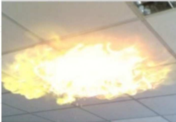
عدم تفاعل السقف مع الحريق
